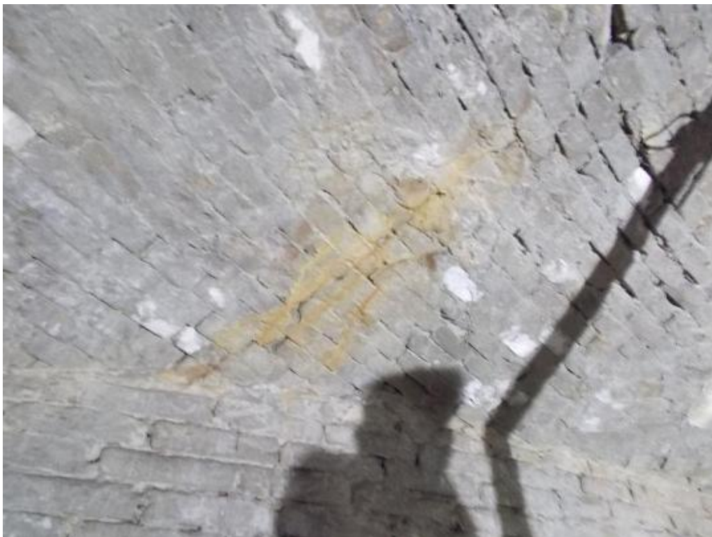
17. sz. melléklet Az I. pincehelyiség beázásból eredő elszíneződése
